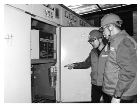
工作人员正在为企业检修维护用电设施。
