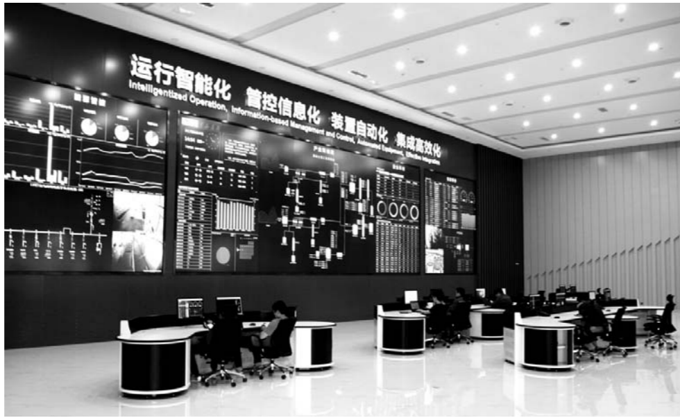
东岳集团智能化管控中心控制大厅。
