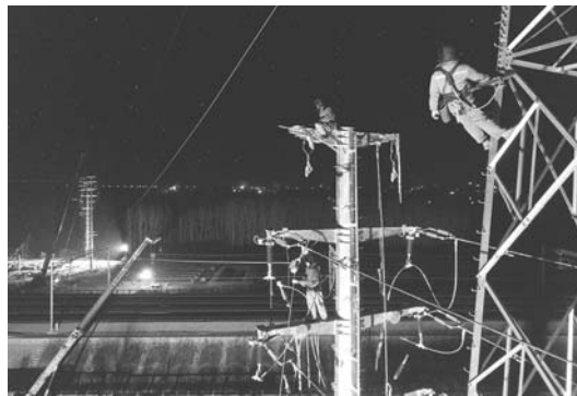
□栗晨皓 孙宝山 李晓琳 报道 12月9日凌晨1时许，气温零下7摄氏度。为确保青盐铁路顺利通车，国网日照供电公司施工人员冒着严寒对跨越青盐铁路的架空电力线路进行拆除作业。目前青盐铁路在行车试验阶段，接触网已带电，白天试跑车辆较多。为避开试车高峰，最大限度降低停电对铁路运行的影响，国网日照供电公司最终确定施工时间为23:30至次日凌晨3:30。
