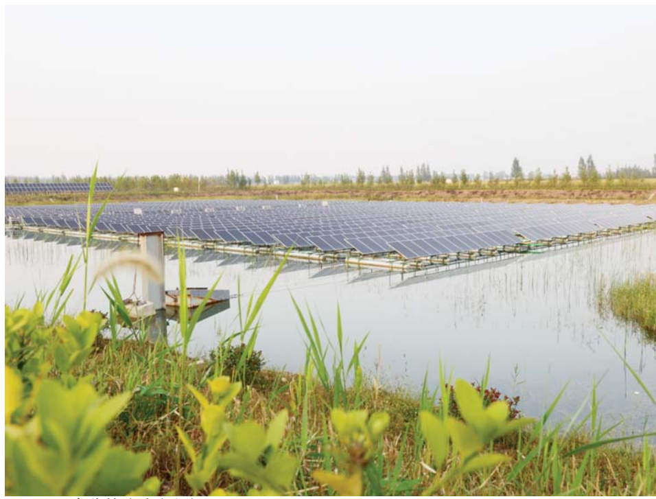
位于卢营村的漂浮发电园区。
