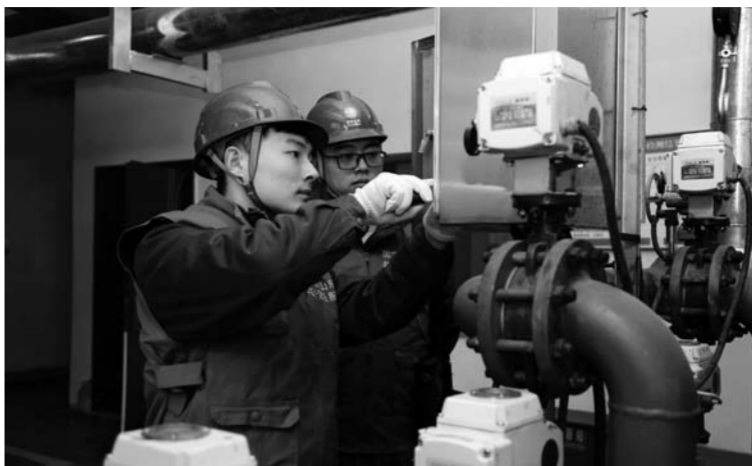
△济南供电公司员工走进辖区“电采暖”项目现场对设备进行安全体检
