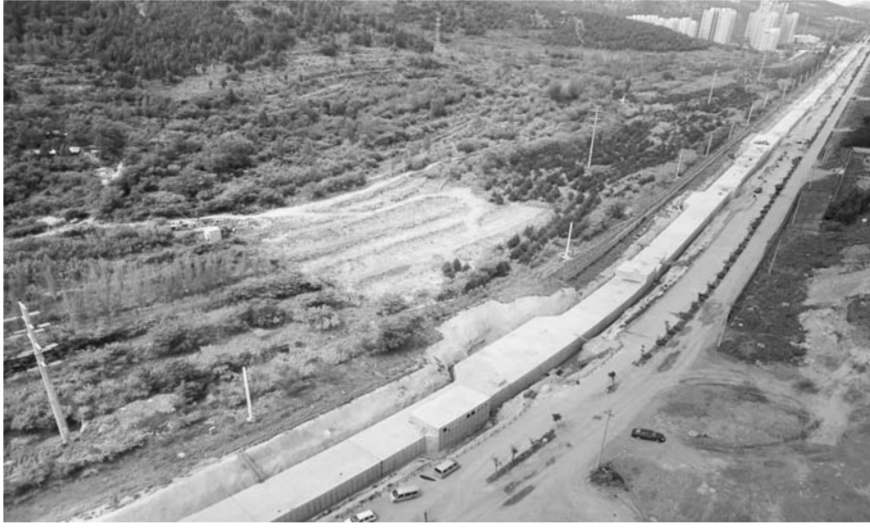
由中建路桥集团有限公司投资建设的济南创新谷片区PPP项目芙蓉路综合管廊工程，目前正在紧张的建设中。这是一项“民生工程”。通过在城市地下建设用于集中敷设多类型市政管线的公共隧道——综合管廊，有利于提高城市综合承载能力和城镇化发展质量。(顾奇峰)
