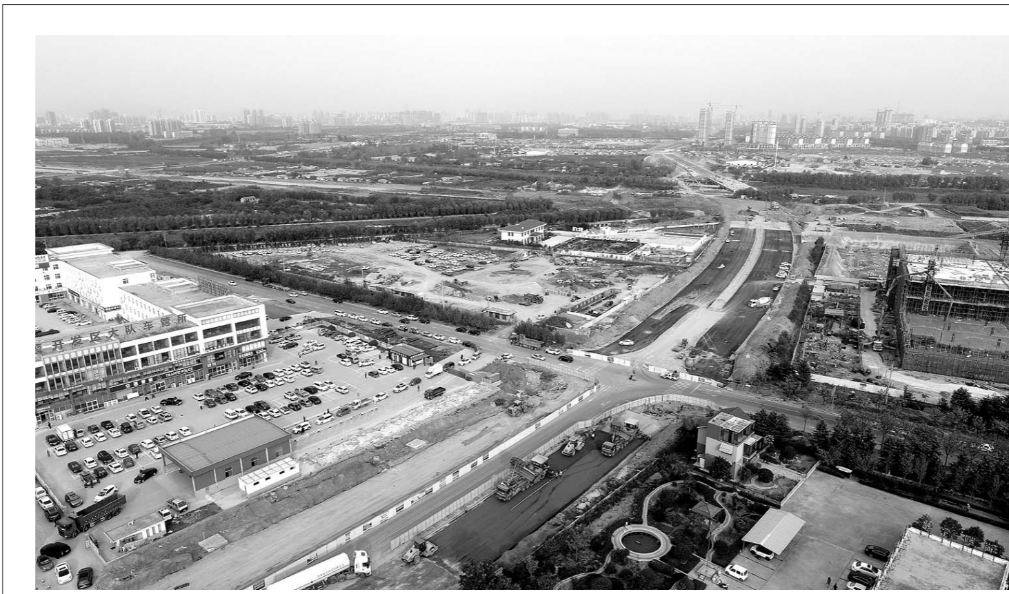
9月9日，日照开发区集中优势力量，针对基础设施建设与综合整治，启动了基础设施建设百日会战。图为日照开发区秦皇岛路拓宽改造现场。
