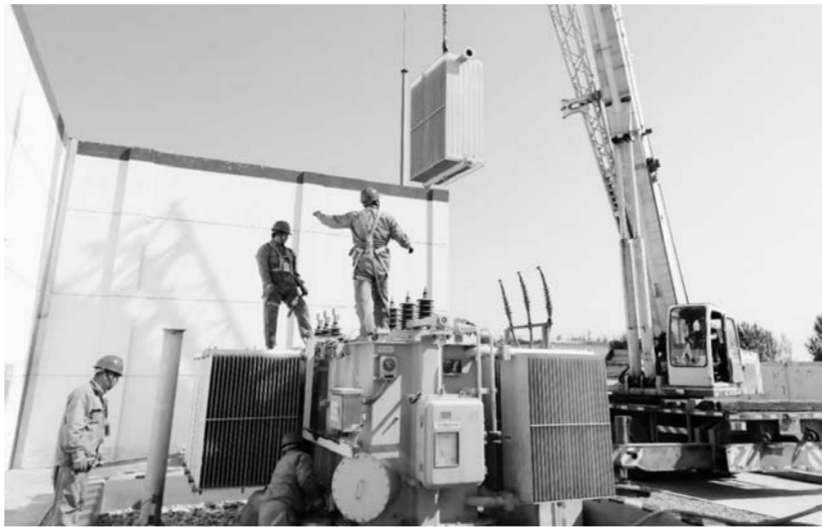
△10月17日，为提高变电设备利用率，根据变电站负荷情况变化，国网平阴供电公司启动了历史上最大规模的35千伏主变迁改工程。施工中工作人员加班加点，不分昼夜，为保障迎峰度冬用电高峰期可靠供电打下良好基础。(石凤盈 左丰岐)
