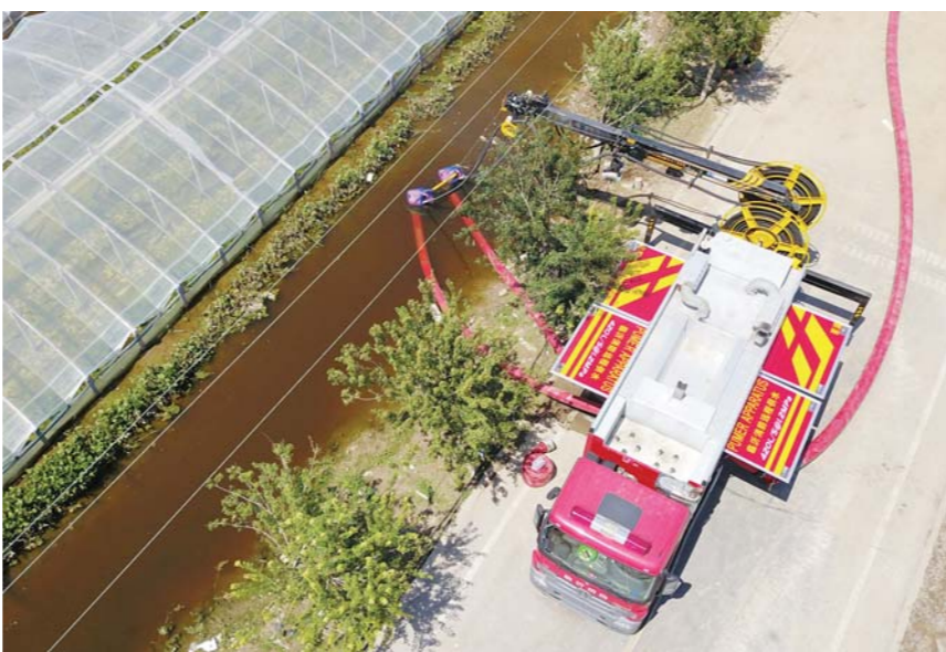
图为8月27日,消防官兵帮助青州市谭坊镇群众排除内涝。
