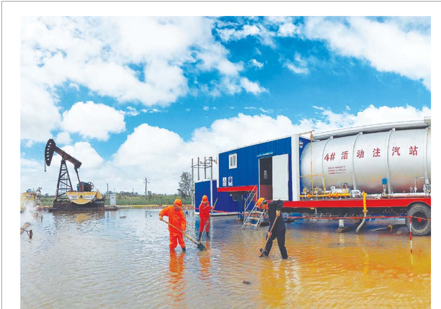
台风“温比亚”所带来的强降雨，造成胜利油田孤岛注汽大队注汽4号、14号站水位超过40厘米，干部职工加强注汽现场管理，架高相关流程管线，保证安全高效运行。
