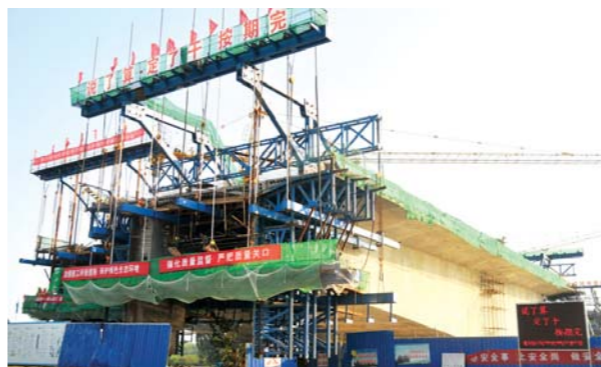
7月19日，G105京澳线汶上至任城界至唐口段改建工程京杭运河大桥项目现场，工人们正在紧张施工。
