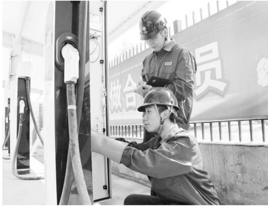
7月12日，国网莱芜供电公司工作人员在凤城科技园莱芜电动汽车充电站，对直流一体化充电桩运行情况进行安全检查，确保迎峰度夏期间充电服务网络安全稳定运行。（毕翠莉 左丰岐）
