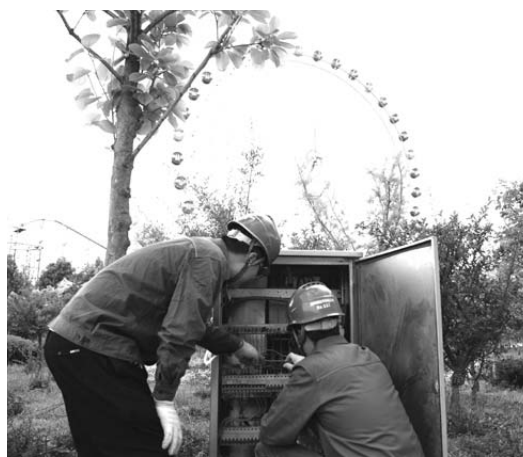
□陈宇飞 左丰歧 报道 6月15日,国网招远市供电公司员工邵杰、王海平对假旗山游乐园用电设备进行细致检查,保证端午小长假期间用电可靠。
