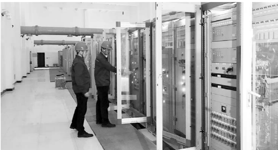
△5月25日，在马青变电站项目改建现场，国网济宁供电公司员工正对设备进行调试
