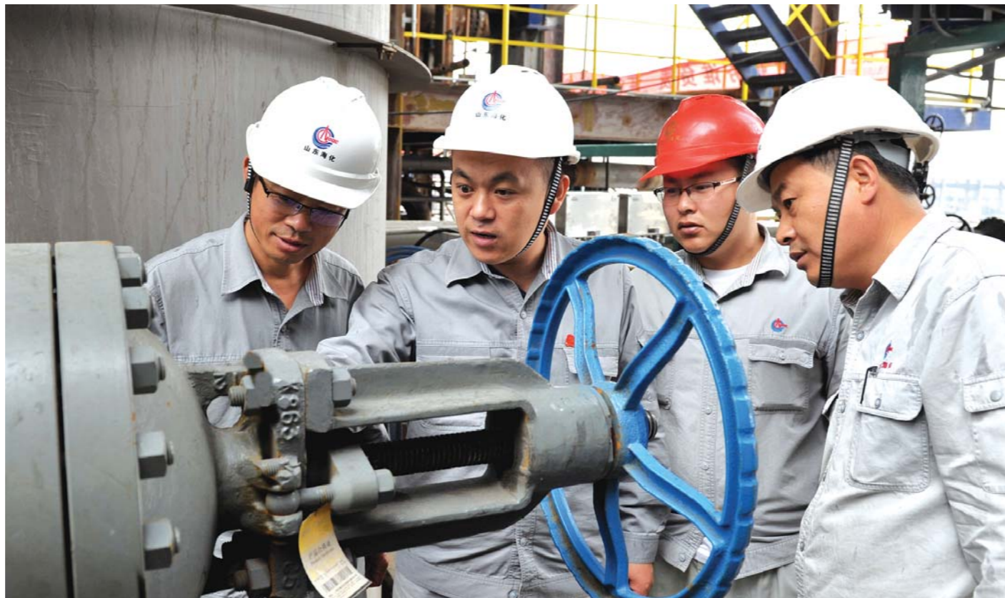
山东海化集团石化一体化项目现场，工作人员正在巡检。
