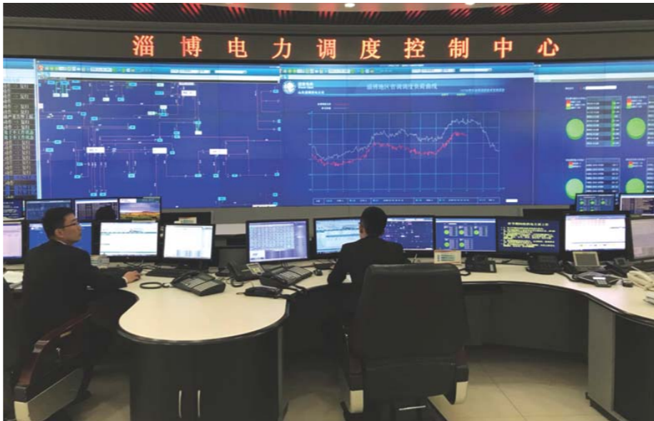
▲淄博供电调度大厅内，工作人员正在进行监控调度。
