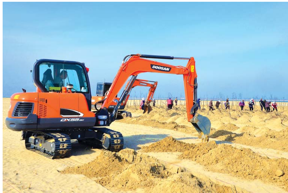
在潍坊滨海旅游度假区老虞河防冲闸南侧,机械、工人共同协作,共筑绿色长廊。
