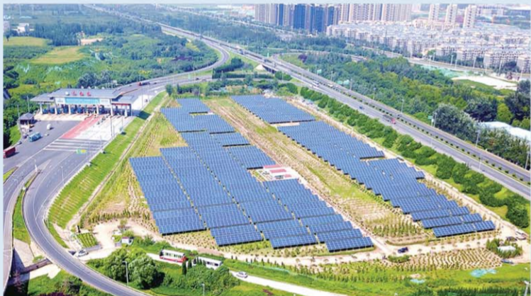
△分布式光伏发电项目
