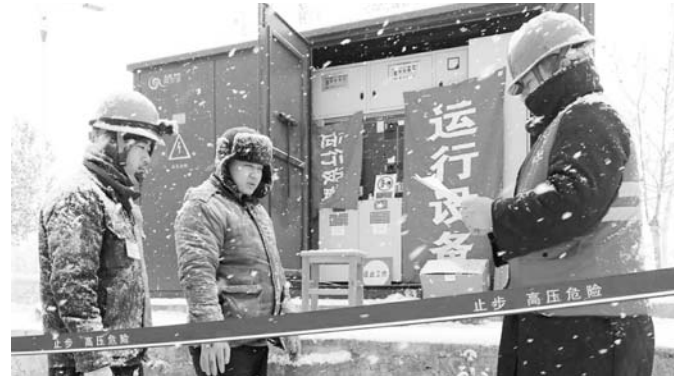
12月11日，烟台市又飘起了鹅毛大雪，烟台供电公司工作人员在10千伏车门线13号环网柜为香槟小区接火送电，保障居民安全可靠用电。（梁莎莎）
