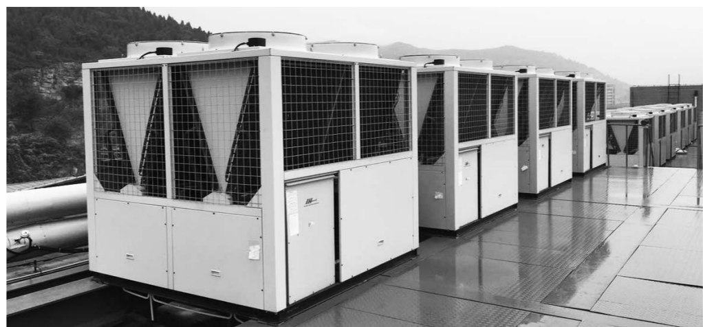
山大兴隆山校区空气热泵源。(资料片)
