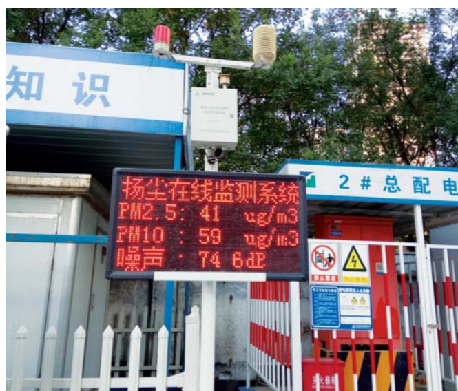
济南施工现场扬尘在线监测系统。
