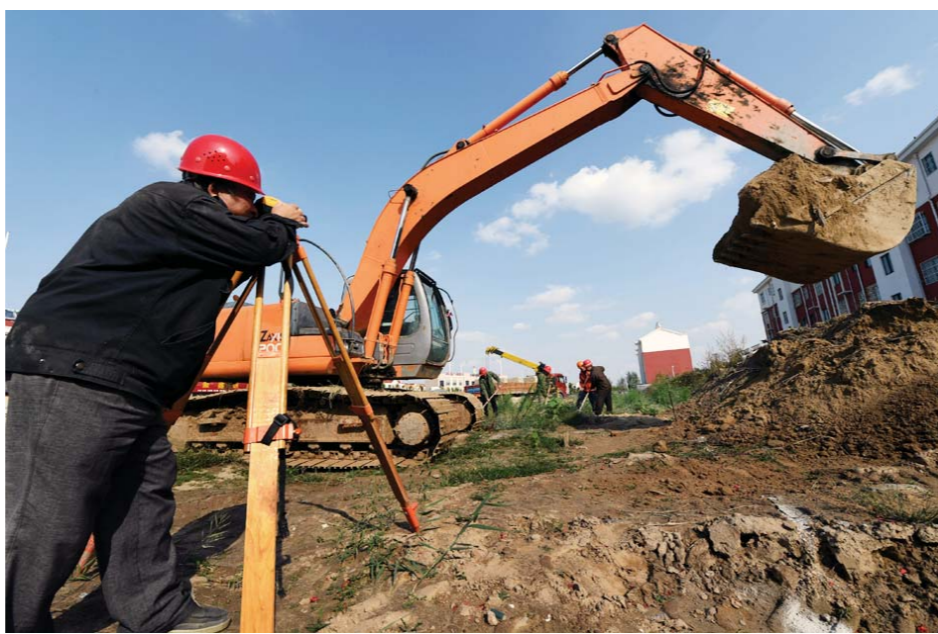
为东营市垦利区董集镇杨庙社区配套的商铺楼开工建设。(李勇 摄)
