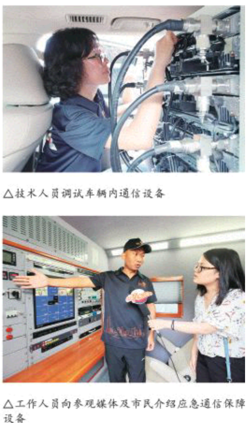
△技术人员调试车辆内通信设备
