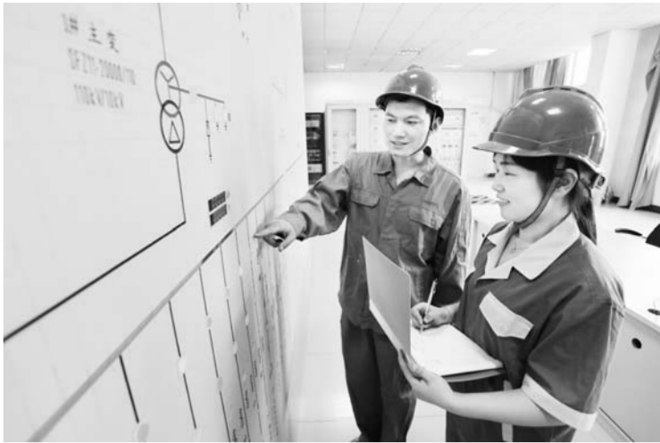
为满足矿井“十大技改工程”对供电系统的技术要求，郭电煤矿陆续对矿井供电系统进行了升级改造，累计更换43台保护装置，消除了变电站存在的隐患，提高了供电系统的保障能力。图为工作人员对高压机柜运行参数进行跟踪记录。（徐虎 左丰岐）
