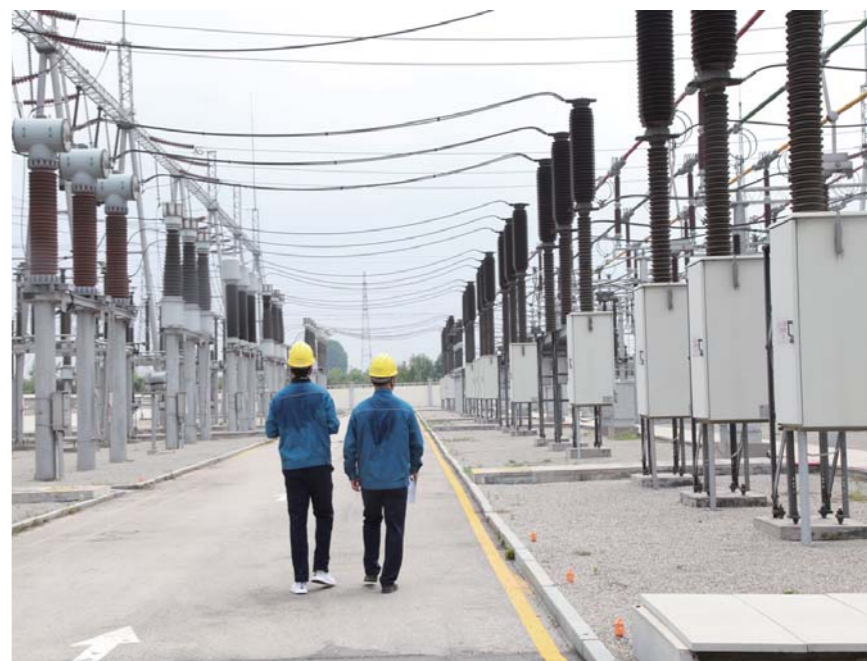
△国网泰安供电公司变电运维人员冒高温特巡变电站设备保供电
