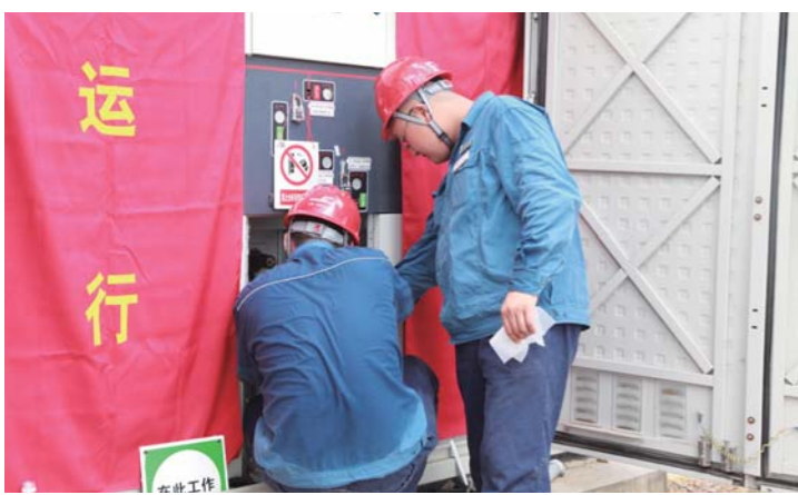
△国网泰安供电公司工作人员冒高温为泰安市高新区用电客户开展业扩增容服务
