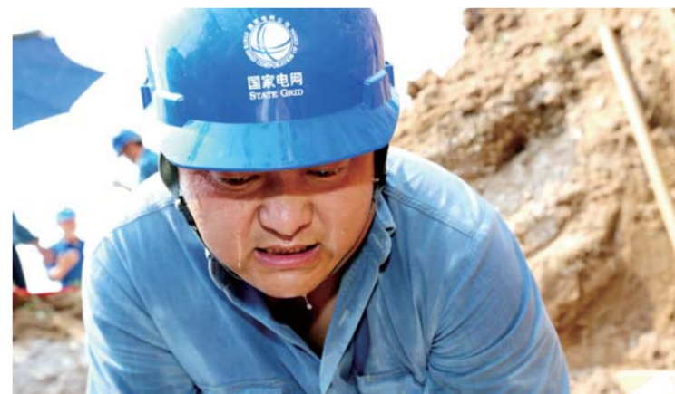
△7月10日，安丘市10千伏金融线地下电缆被挖断，安丘市供电公司员工冒着30多度的高温，在最短时间内恢复供电 □摄影：李文博
