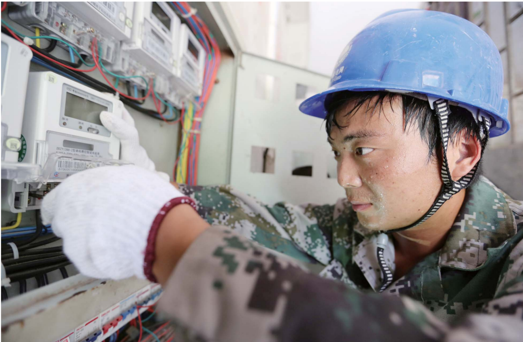
△7月5日，菏泽成武县供电公司员工，在中医院小区闷热的楼道内为小区居民更换计量表
