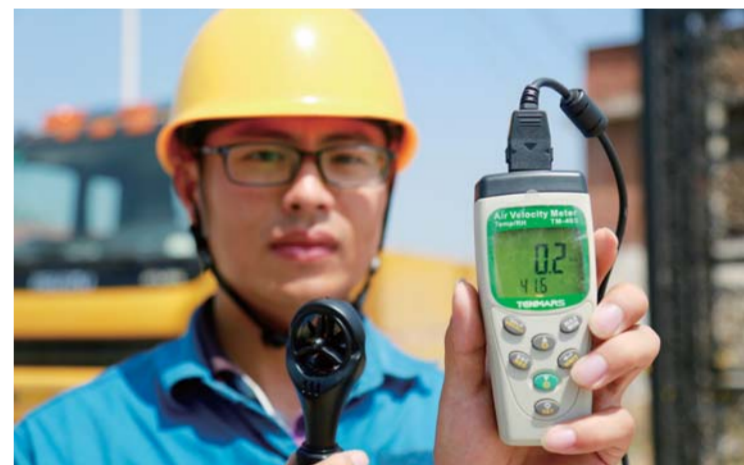
△7月10日，淄博供电公司员工烈日下为10千伏高塘线高塘北支线更换导线。测风测温仪显示当时温度41.6摄氏度 □摄影：李汉栋
