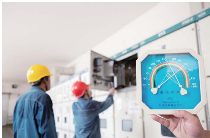
△7月4日，嘉祥县供电公司工作人员对20所变电站开展中、晚两个高温高负荷阶段精确测温，确保全县居民迎峰度夏用上放心电、舒心电 □摄影：王者东
