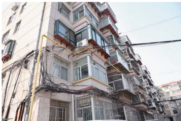
△东二区楼房杂乱线路一角
