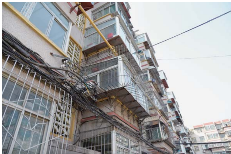
△东二区单元之间落地前的凌乱线路
