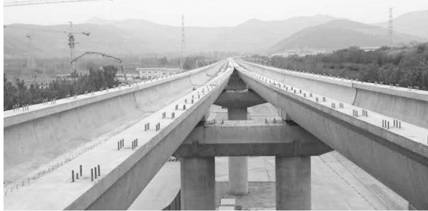
截至目前,济南轨道交通R1线试验段的前大彦车站已完成主体结构,正在进行车站围护与附属结构的施工。
