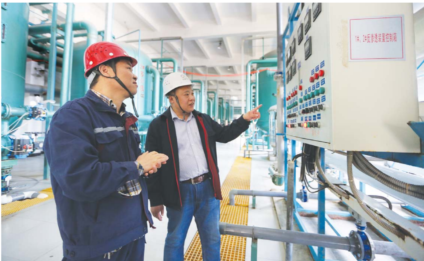
针对停暖后的热力企业安全生产工作,4月6日,潍坊高新区安监局工作人员来到华潍热电有限公司等企业进行安全检查。检查内容包括安全制度和责任落实情况、供热储煤、安全防火、设备设施、作业现场安全、重点部位巡查管理、应急保障等情况,全面做好安全生产隐患排查治理工作。
