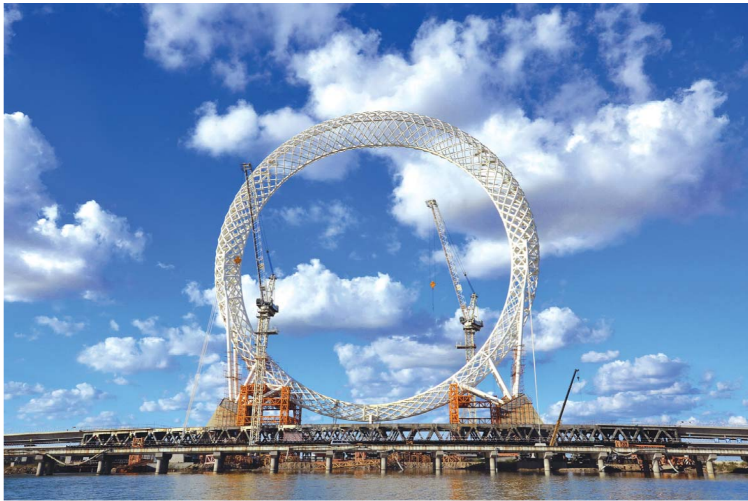
近日,世界上最大的无轴式摩天轮——白浪河大桥摩天轮开始安装轿厢。该摩天轮位于潍坊滨海区白浪河大桥中央,轮盘直径达125米,总高度为145米,摩天轮观光缆车轿厢36个,每个轿厢可容纳10人,每转运行时间约28分钟,是世界上首例编织网格式摩天轮和世界上首次无轴式轮桥合一的摩天轮。
