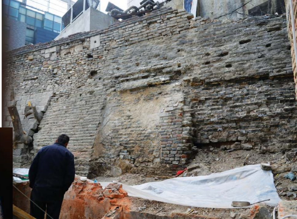
3月20日，老城墙前已搭建起临时围挡，相关单位派专人24小时值守看护，看护人员(左下)在门缝中向记者展示古城墙遗落的砖石。
