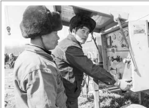
3月9日，内蒙古上海庙至山东临沂±800千伏直流输电工程山东泰安东平县东平湖滞流区新湖段顺利放线施工。（方军）
