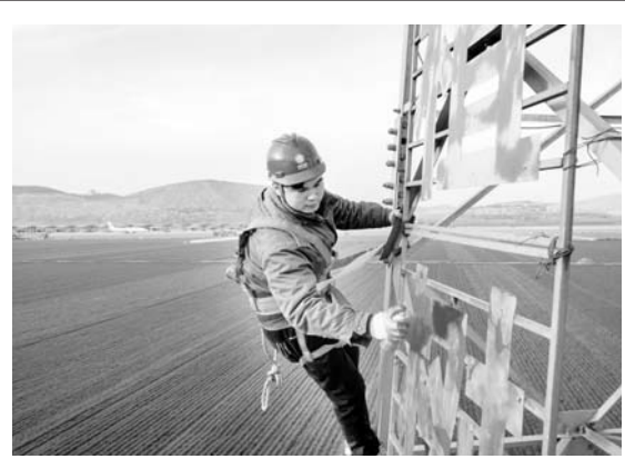
2月20日，国网济宁嘉祥县供电公司输电运维人员开展“警示标语上塔”专项行动。该公司共喷涂警示标语10000余份，走村入户宣讲电力设施保护常识213人次，向沿线群众发放宣传单600余份。（王者东）
