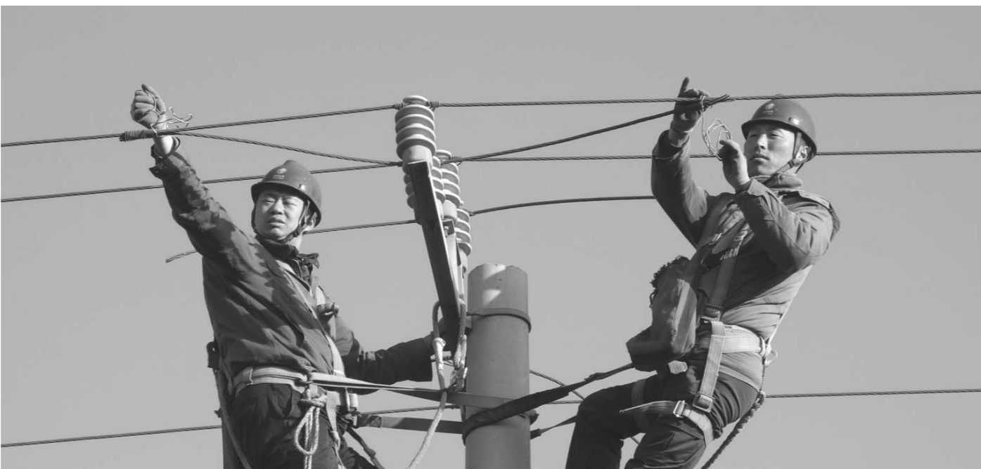
11月30日,国网莱州市供电公司全力奋战10千伏西农线农网改造工程,架设240平方米毫米绝缘导线1000米,组立15米电杆15基,为线路安全可靠运行打下坚实基础。 □ 赵冬 杨景茹 报道
