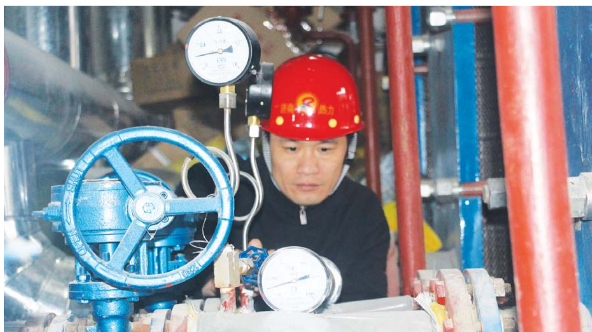
□ 高亚宁 秦清 报道 位于奥体西路北段的万科城小区将于今冬集中供暖，该小区共计供热面积33万平方米，约2800户居民。目前，小区换热站正在进行注水冲洗。11月7日，康虹路片区供热站站站长郭玉峰帮助检查站内压力。据悉，高新区万达小区的商业区和部分居民区约30万平方米供热面积，今冬也将加入集中供暖任务中。
