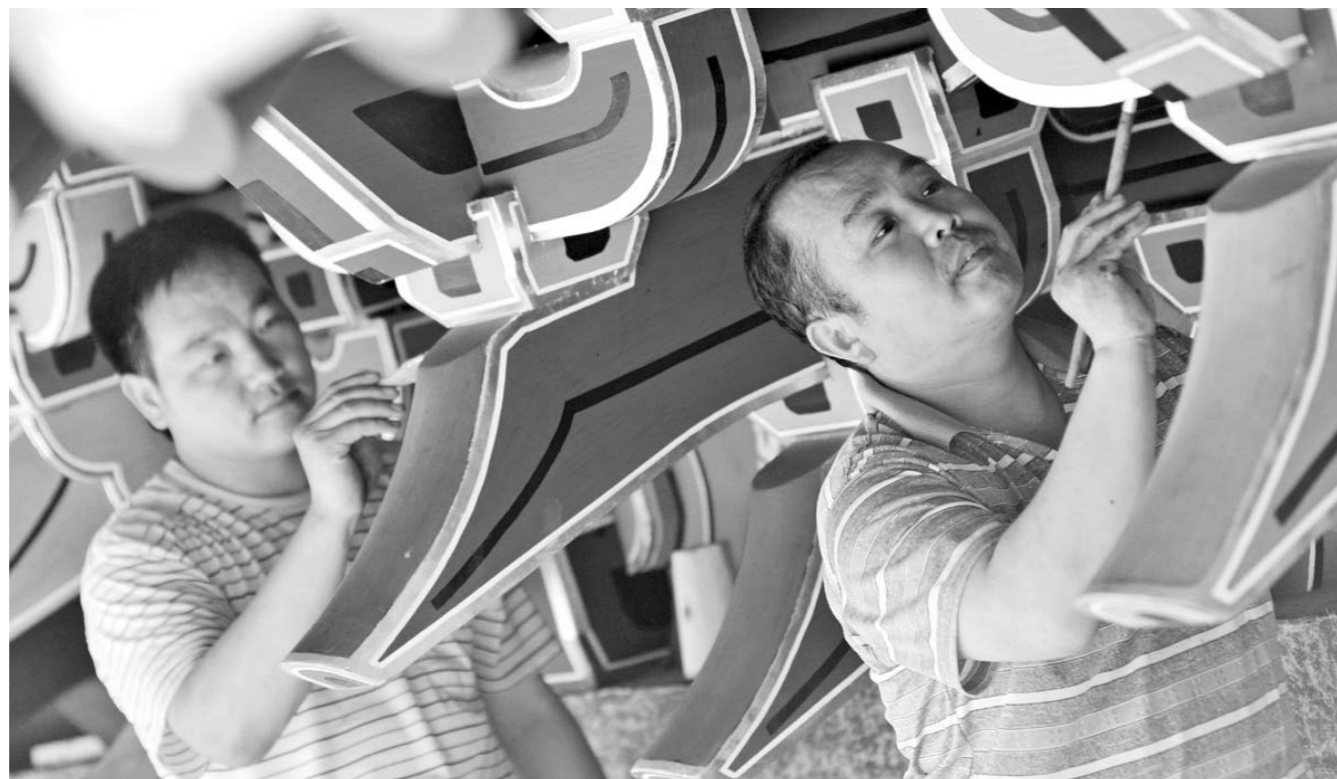
彩绘修复要经过一道道复杂的工序，每一个细节都饱含了匠人们的心血。(□孟一 报道)
