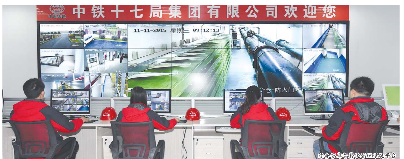
综合管廊智慧化管理系统平台
