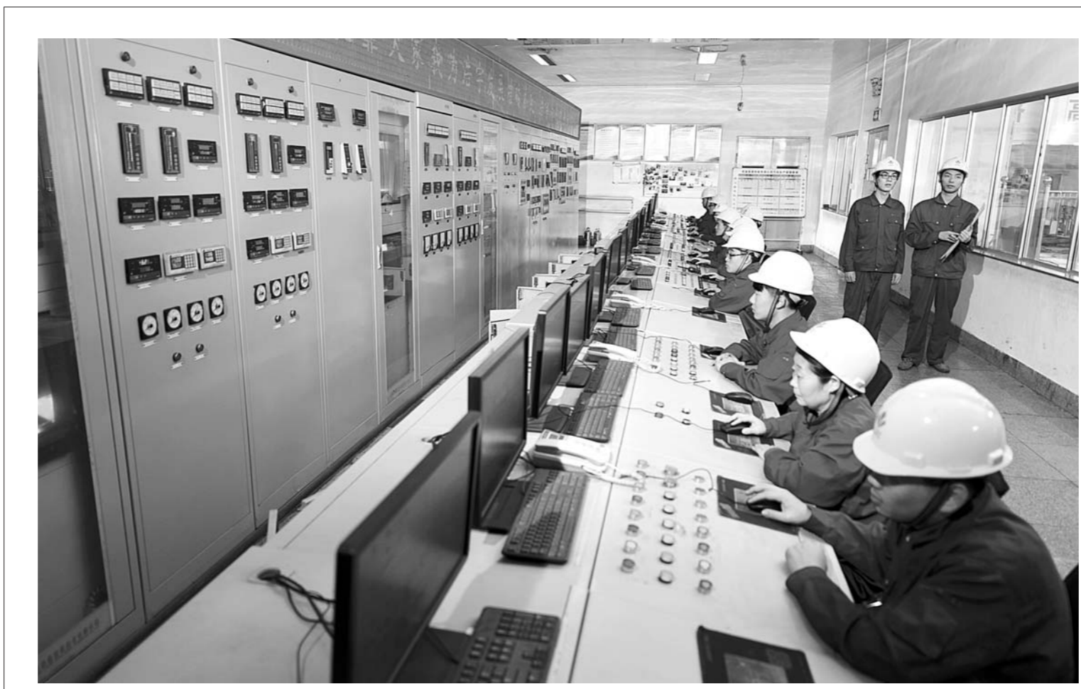
莒县按照“全党抓经济、重点抓工业、关键抓投入、突出抓招商”的工作思路，优化存量，扩大增量，膨胀总量，持续推动工业转型升级、跨越发展，打响振兴工业新战役。年内，力争引进投资过5000万元项目73个、过10亿元项目3个；新发展市场主体1000家、中小微企业500家，形成大企业顶天立地、中小微企业铺天盖地的生动发展局面。图为莒县重点企业丰源热电厂的中控室。
