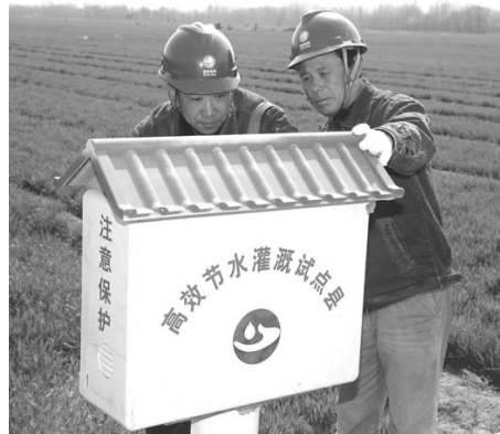
□钱新江 报道 3月30日，国网高青县供电公司“小农水”供电设施进行检查维护，确保群众春灌用电及时可靠。
