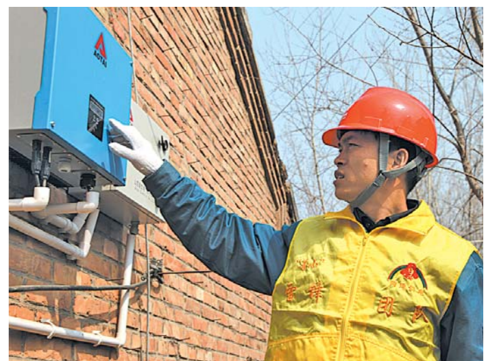
□夏龙臻 报道 3月23日,国网郯城县供电公司组织“善小”志愿者走进光伏扶贫安装点,为用户的光伏设备进行检查,了解光伏设备运行情况。
