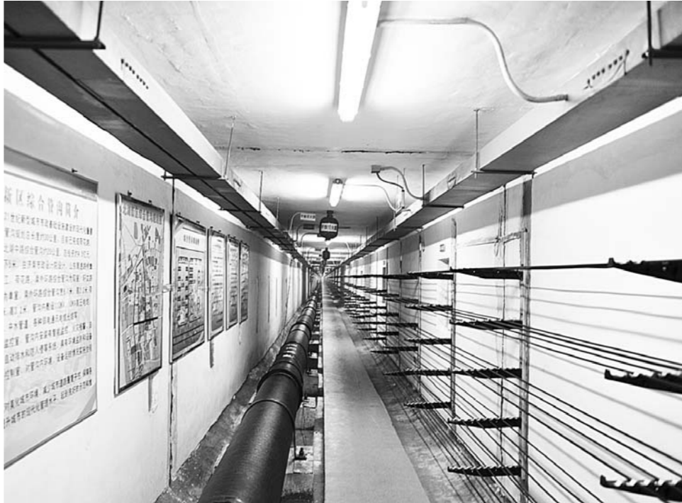
太白湖新区荷花路地下综合管廊。（资料图）
