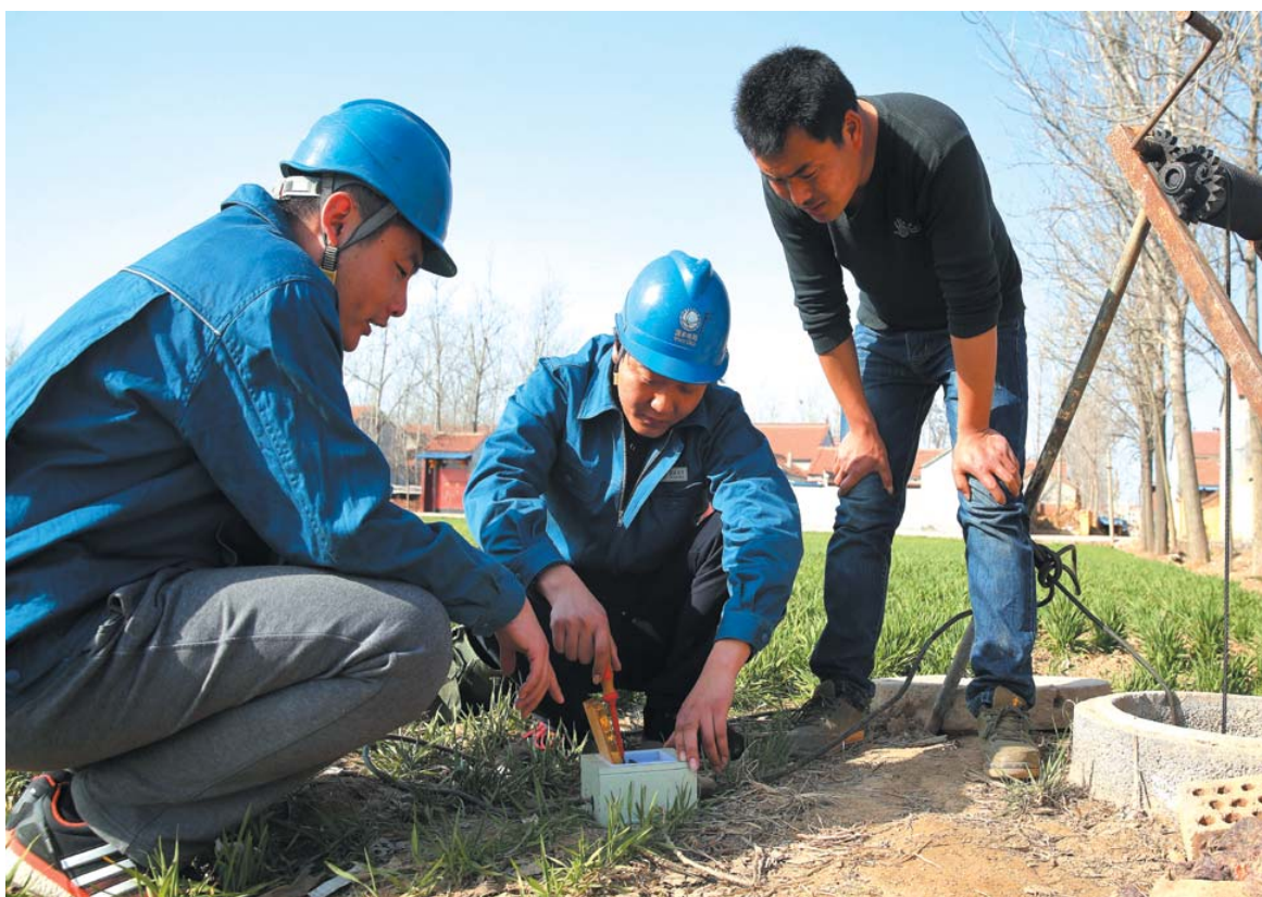
□李庆瑞 报道 3月3日，国网成武县供电公司春灌保电服务队队员在丁张庄，为农民安装春灌用电设备，同时对用电线路和设施进行检查，确保农民春灌用电无忧。
