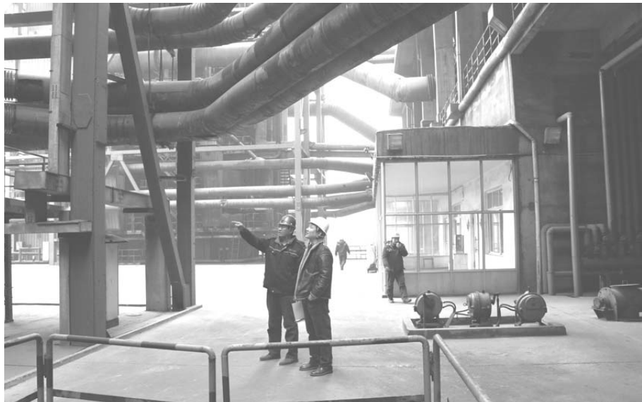
1月19日,寿光金太阳热电厂限产现场,工作人员正在进行设备检查。
