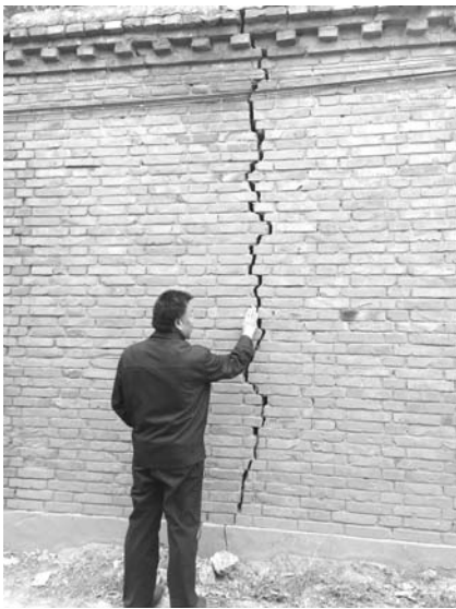
△在河北省柏乡县的地下水超采区，一些村民家墙壁、地面有裂缝。
