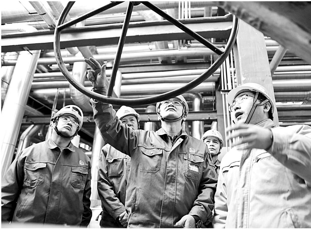
近日，齐鲁石化强化安全管理力度，对装置现场设备安全进行认真排查。图为齐鲁石化炼油厂蜡油加氢装置员工排查隐患。
