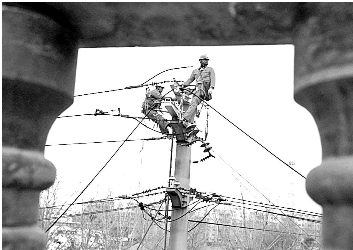
12月9日,国网枣庄市供电公司山亭客户服务中心联合三个施工队176人,联手对110山亭千伏变电站10千伏岩底线路和山工线路进行联网拉手供电集中攻坚改造施工,共组立杆塔7基,展放高低压绝缘导线3.5千米,安装线路开关3台,更换改造配台区设备5处。
