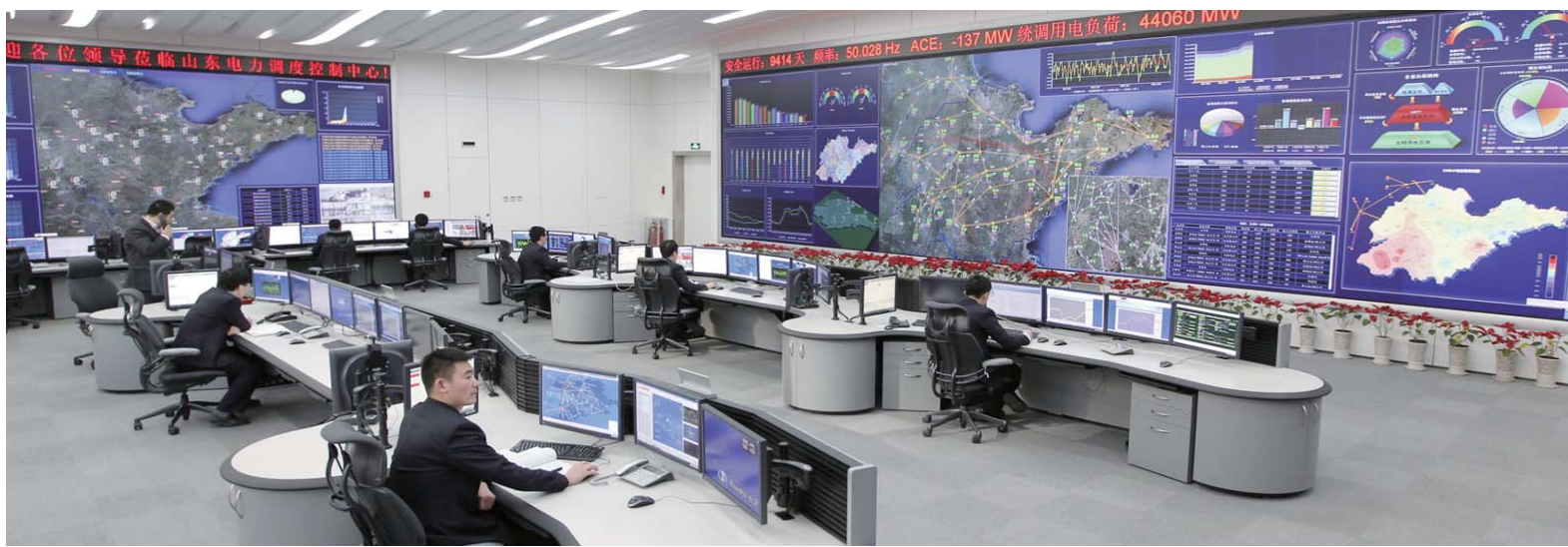
△山东电力调度控制中心调控大厅
