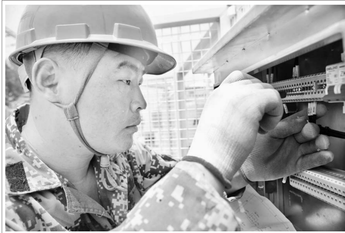
□李庆瑞 报道 为了确保夏季用电高峰期间电力设备安全运行，8月3日，国网成武县供电公司组织电力专业技术人员对配电站主变压器、母线、开关及端子箱内设备等进行红外测温。
