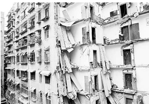
新华社北京6月15日电 记者拍摄的地震后受损房屋。
