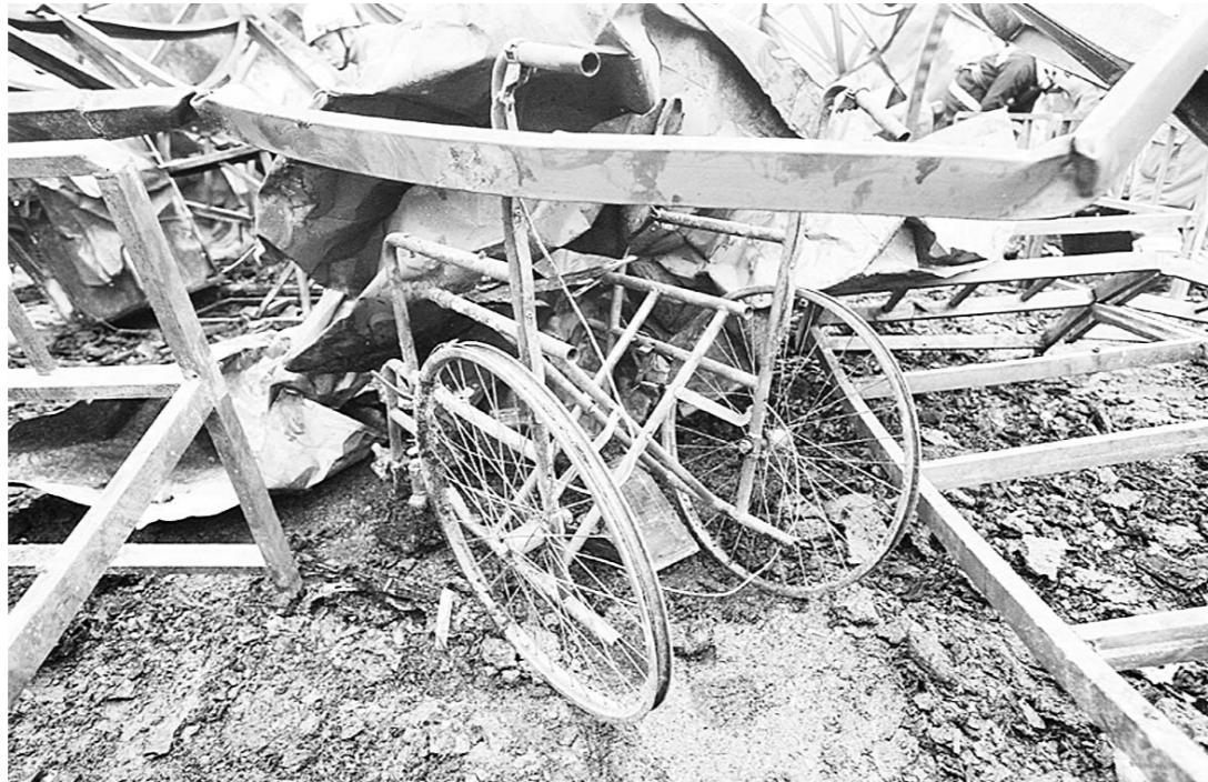
□CFP供图 河南省平顶山市鲁山县老年公寓“铁皮泡沫屋”燃烧过后,只剩下钢架和铁皮。
